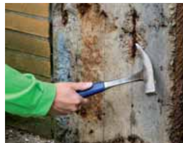
Selvästi näkyvä: Betonin kunnostus on tarpeen
