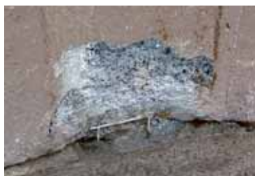
Ennen korjausta: Seinällä ja viisteissä vauriot selvästi näkyvissä.
